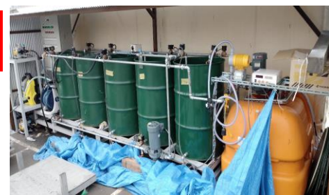
給排水タンク類
