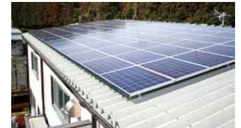
本社工場の屋上に設置した太陽光発電パネル
