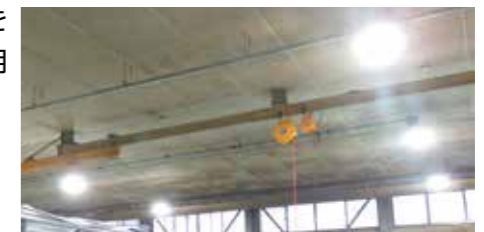
工場に設置されたLED照明
