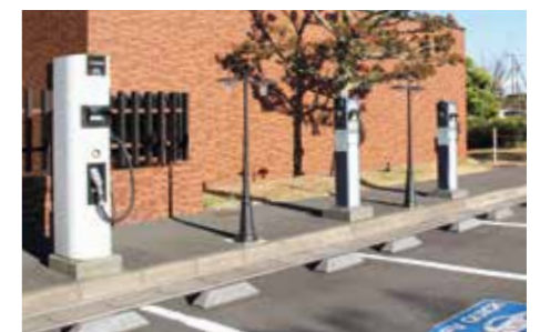
駐車場に設置しているEV充電スタンド
