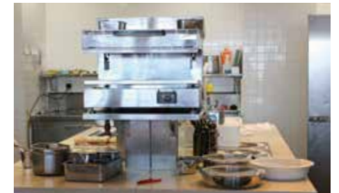
「オールデイダイニング」の厨房設備
