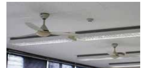
天井に設置したシーリングファン
