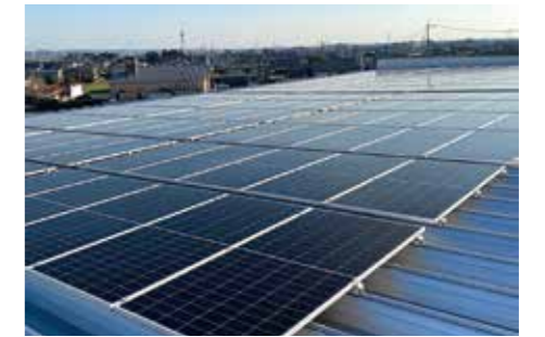
浜北工場の屋上に設置した太陽光パネル
