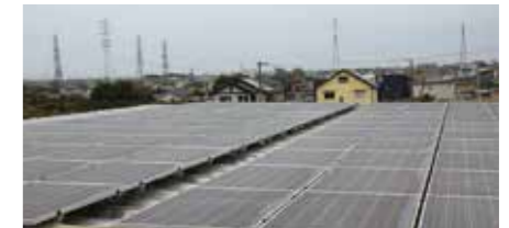
本社工場屋上に設置した太陽光パネル
