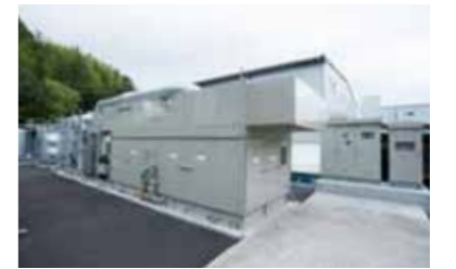
ガスコージェネレーションシステム設備
